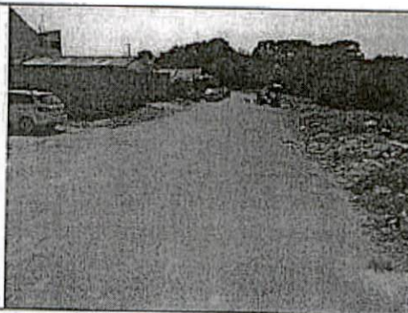
Foto nº 10 – Rua Santo Antônio de Santana Galvão (entre R. São Clemente e R. N. S. do Carmo), sem rede pluvial
